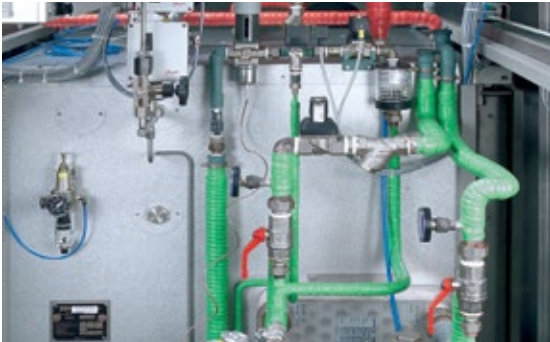
Isolation de la chambre et isolation des tuyaux respectant un code couleur
